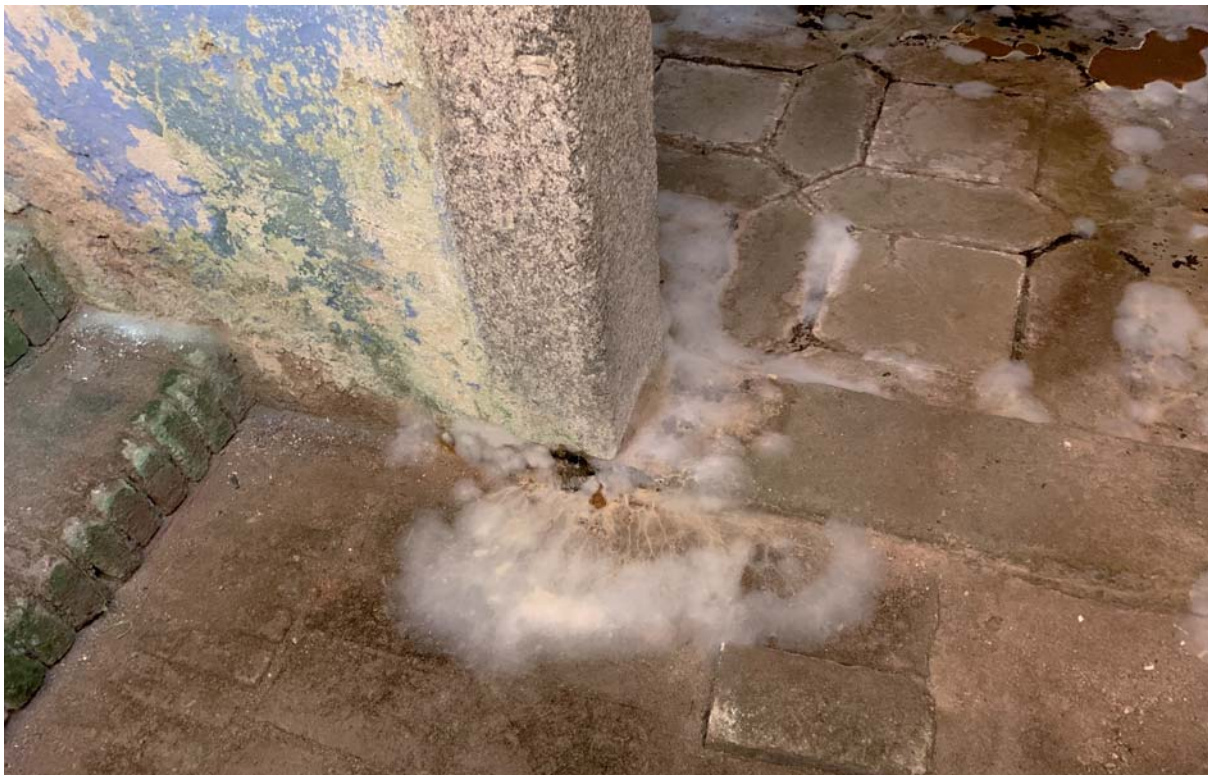
Schlecht: An der Mauer hat sich Haus-Schwamm ausgebreitet.
