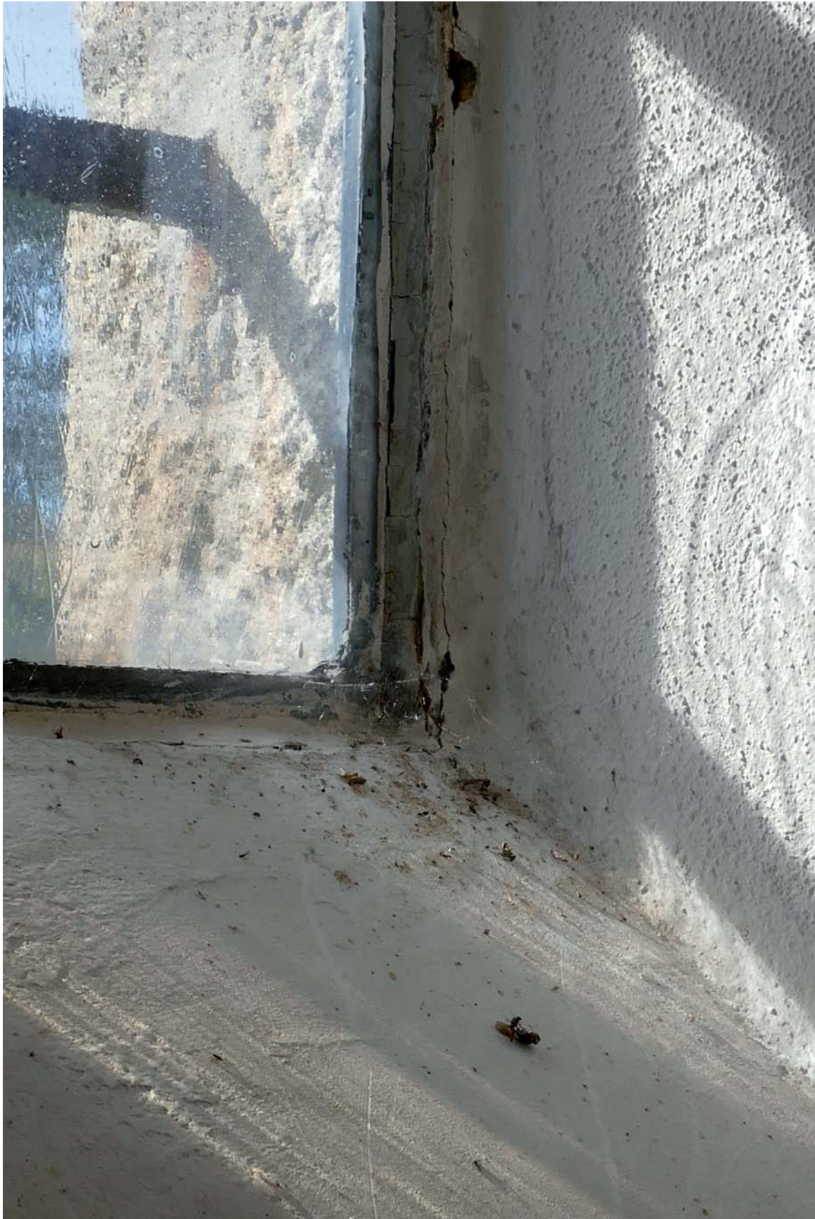
Schlecht: Insekten haben die Wand unter dem Fenster verschmutzt.
