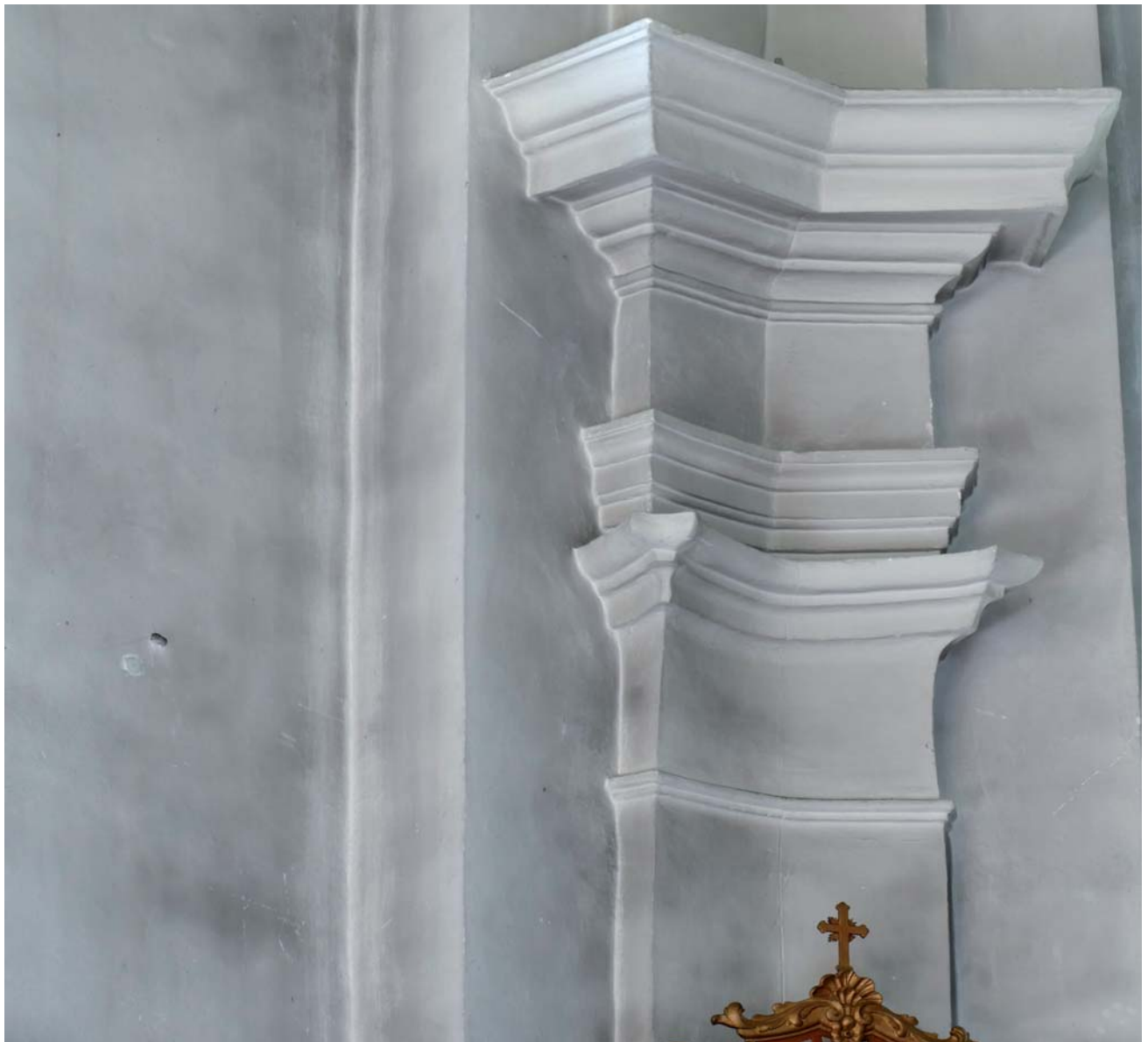
Schlecht: Die Kirchenwand ist durch Ruß verfärbt worden.
