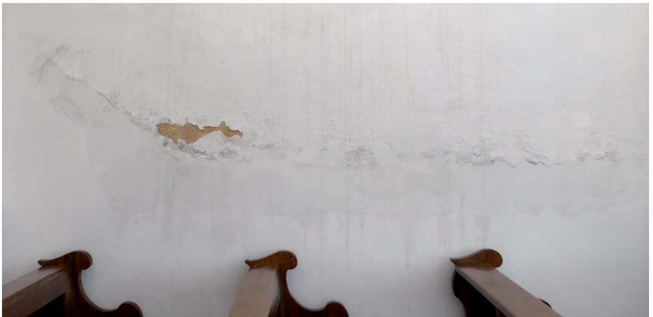
Schlecht: Eine feuchte Wand. Der Putz löst sich ab.
