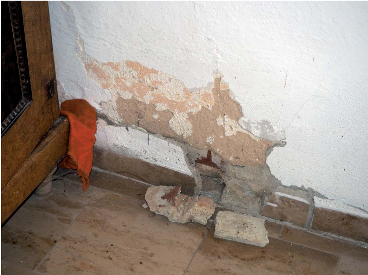
Schlecht: Weil die Wand sehr feucht ist, ist sie brüchig geworden.
